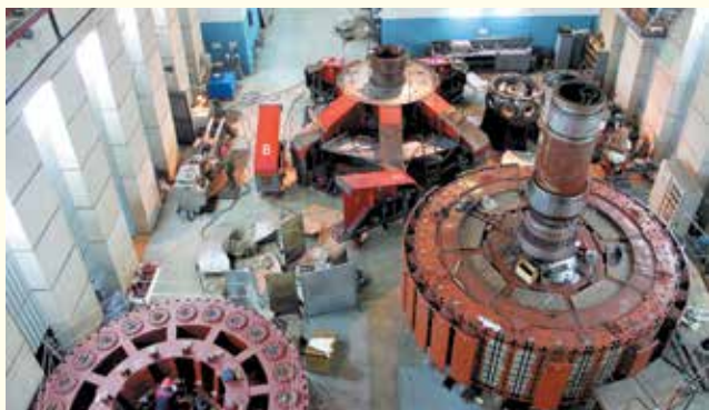
ООО «ВОЛГА-СГЭМ» – «КАМСПЕЦЭНЕРГО» (г. Набережные Челны, руководитель Руденко Александр Леонидович), объект реконструкции «Усть-Хантайская ГЭС в п. Снежногорск, Красноярский край»
