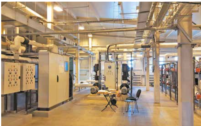
Станция водоподготовки в Приморском океанариуме
