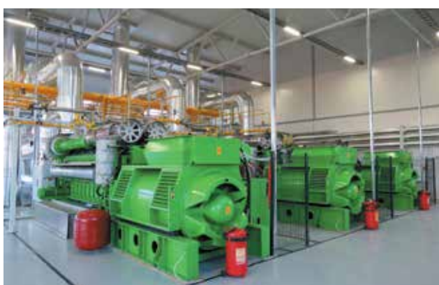
Энергоцентр и мини-ТЭС Заказчик: ООО «Тепличный комбинат «Майский» Подрядчик: ООО «Тепличный комбинат «Майский» Мощность энергоцентров – 47 МВт электрической энергии Обнащение – 14 газопоршневых установок Jenbacher JMS – 620 по 3352кВт Ежегодная выработка – 160 млн кВт электроэнергии, 120 тыс. Гкал тепловой энергии
