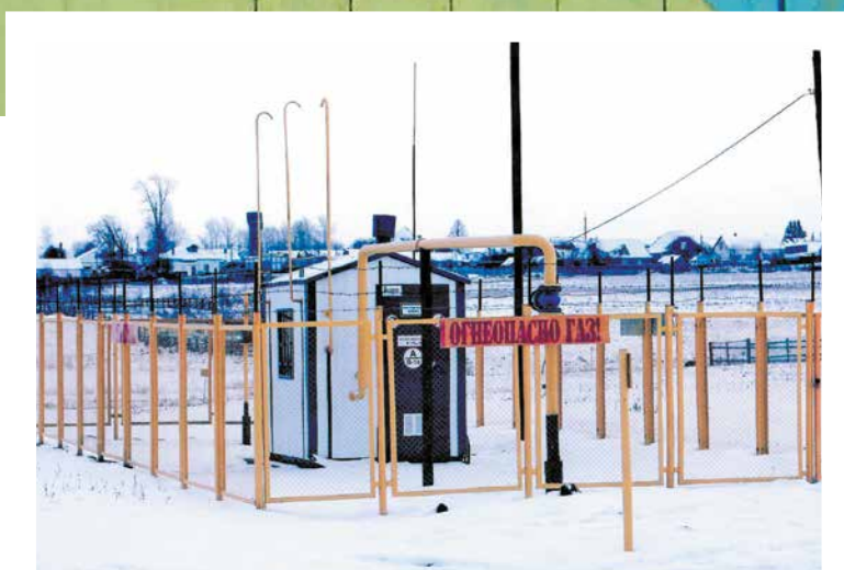
Газораспределительный шкаф, дер. Аняково, ул. Ш. Шаймиева
