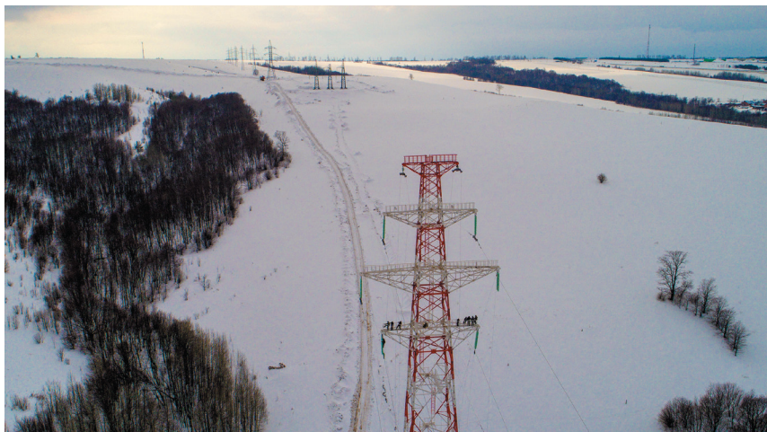
▲ Спецпереход через р. Вятку, ВЛ-110 кВ
